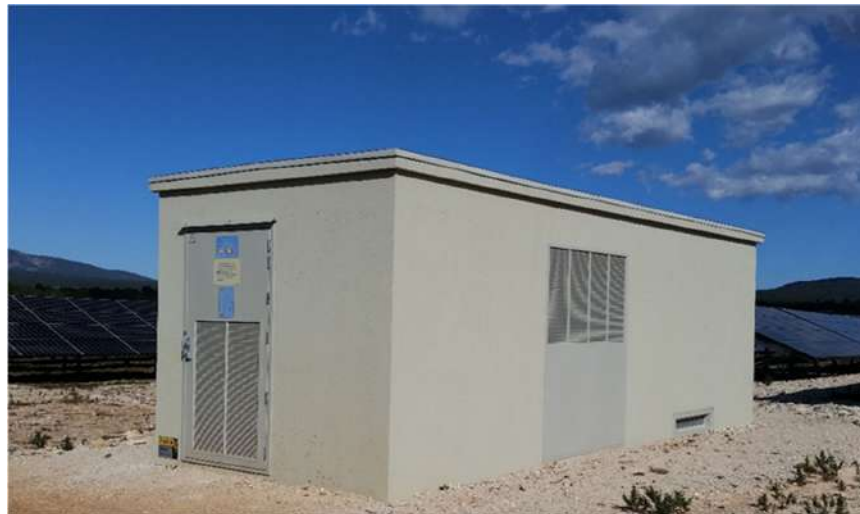
Figure 13 : Exemple de poste de transformation – Parc solaire du Castellet (83). Source : Voltalia.
