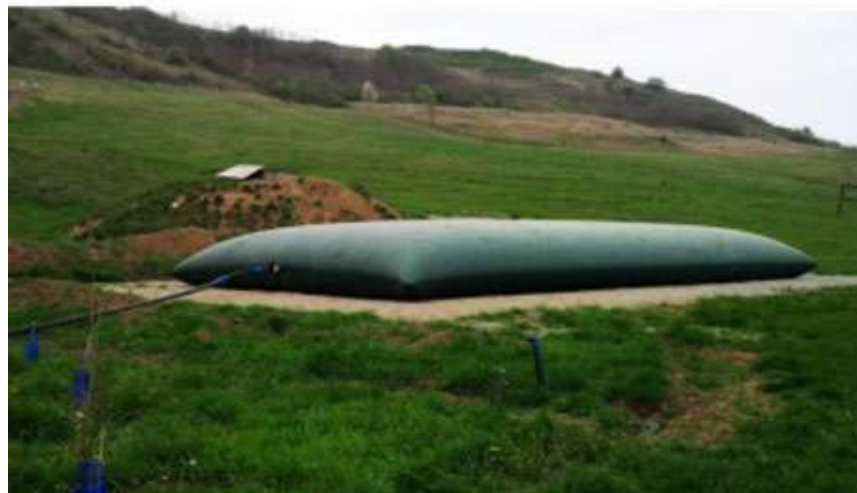
Figure 21 : Exemple de citerne incendie souple. Source : Voltalia.
