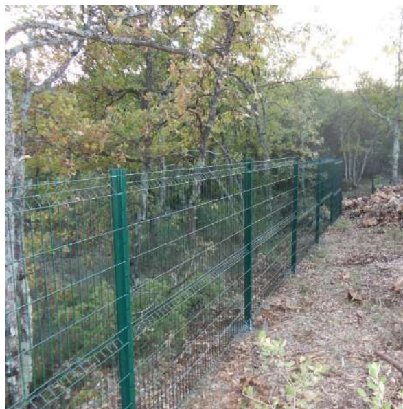
Figure 16 : Exemple de clôture sans bavolet – Parc solaire de Montmayon. Source : Voltalia.
