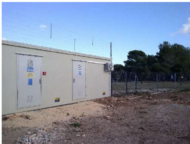
Figure 14 : Exemple de poste de livraison - Parc solaire du Castellet. Source : Voltalia.
