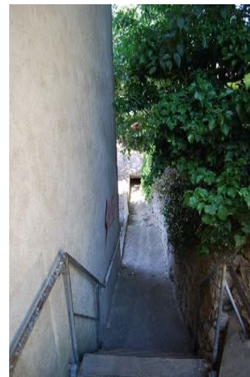
Réseau pluvial busé - Saint-Pargoire Source : Urban Projects
